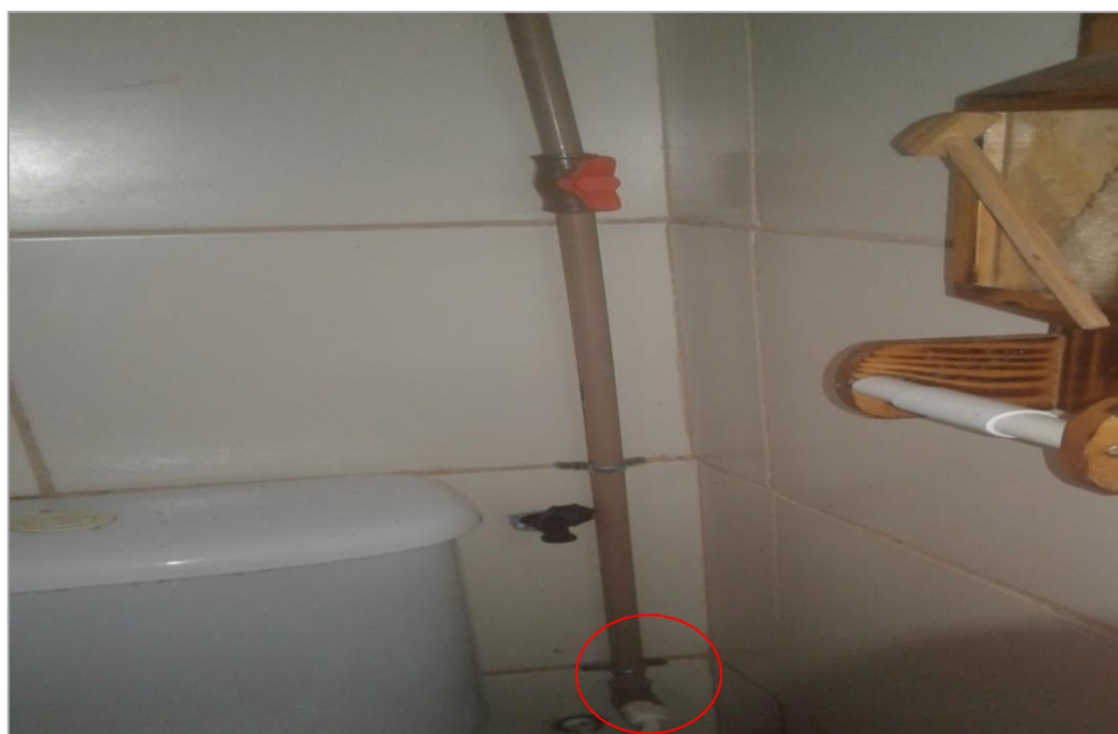
Figura 16 - Ponto de água referente à descarga o vaso sanitário.
