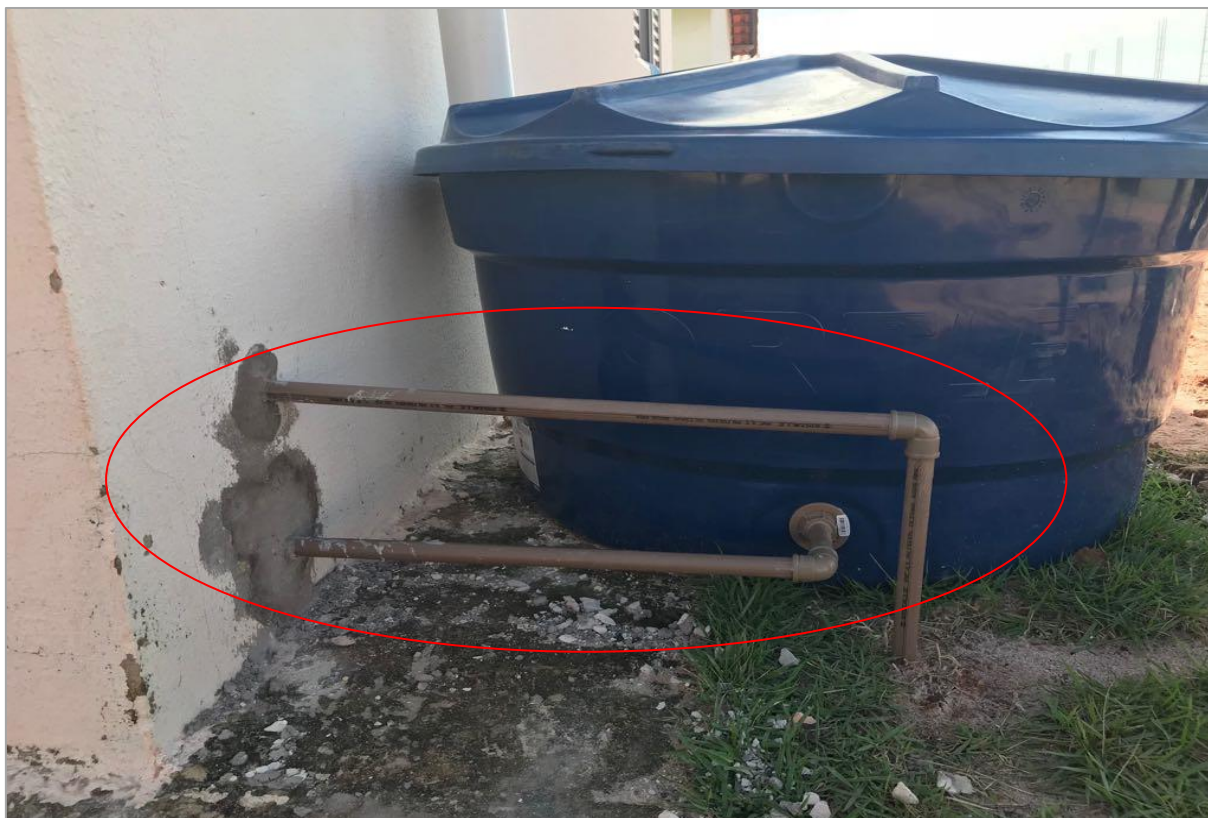
Figura 14 - Ligação externa da bomba e o reservatório interior.
