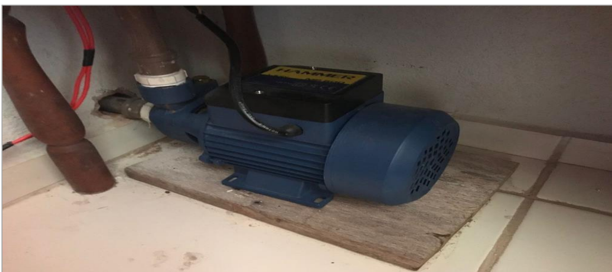
Figura 13 - Bomba instalada na parte interna da residência
