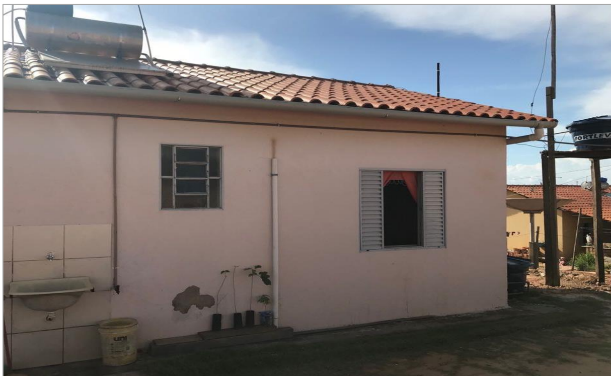
Figura 15 - Rede de distribuição na parte externa da residência.
