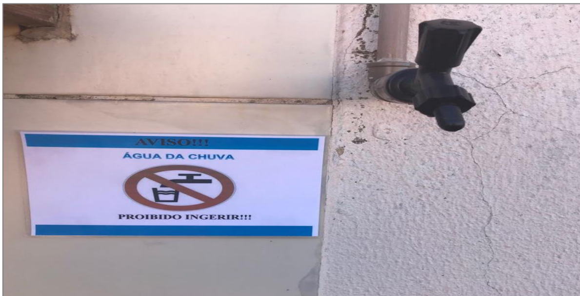
Figura 19 – Placa de Identificação de ponto de distribuição de água de chuva.
