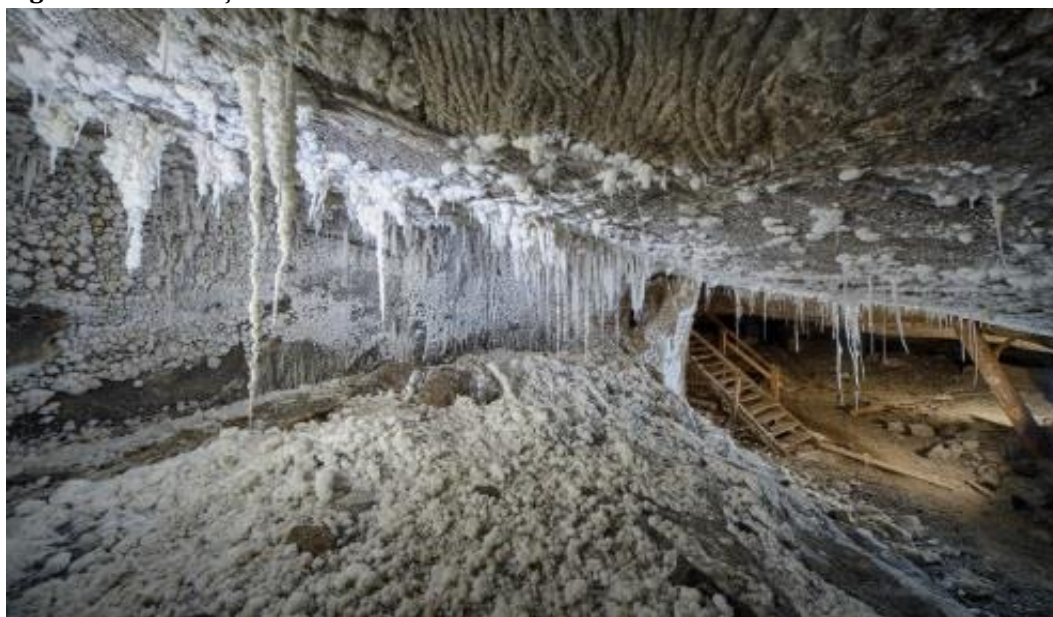
Figura 11 - Presença de sal no interior da mina.
