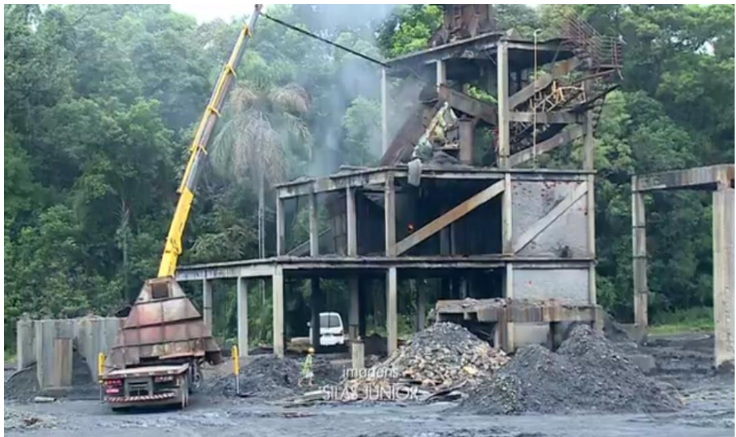
Figura 8 - Estruturas provisórias abandonadas na Mina do Verdinho.
