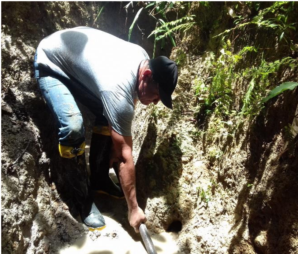
Figura 14 – Colocação de material seco do próprio local para assentamento do tubo Fonte: O autor, 2018
