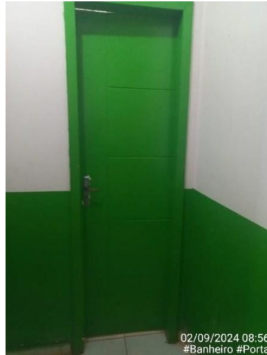
Figura 34 — Porta do banheiro
