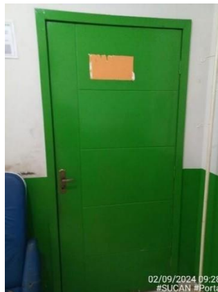
Figura 29 — Porta sem sinalização visual
