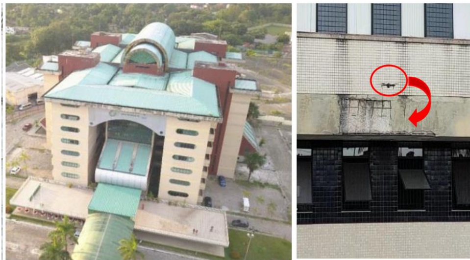
Figura 8: Manifestações Patológicas na engenharia Civil
