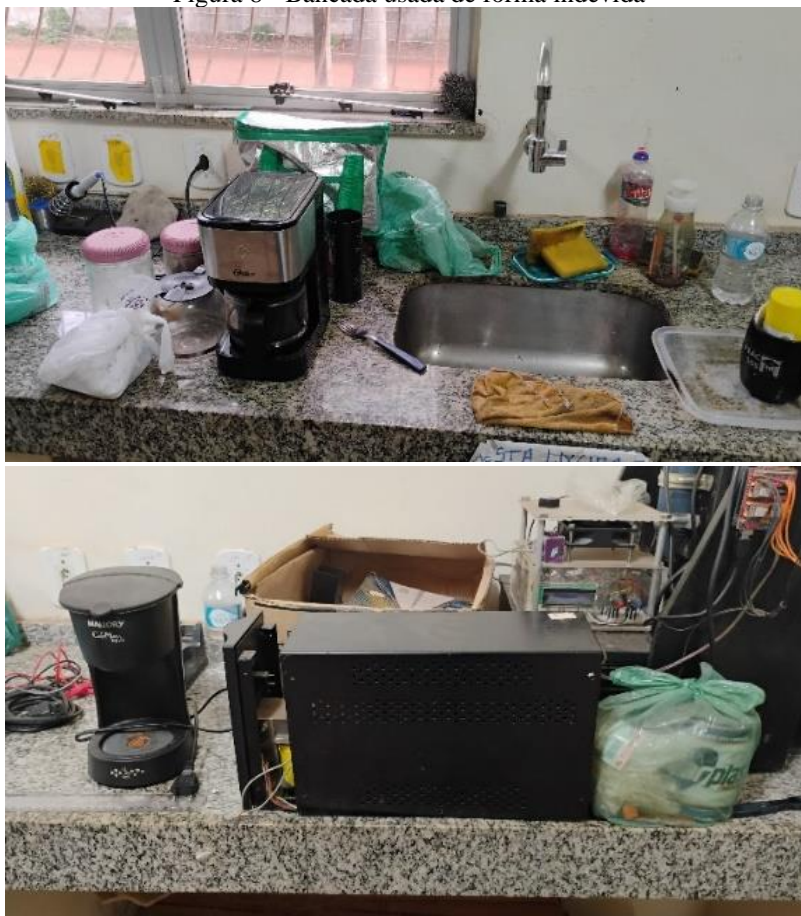
Figura 8 - Bancada usada de forma indevida
