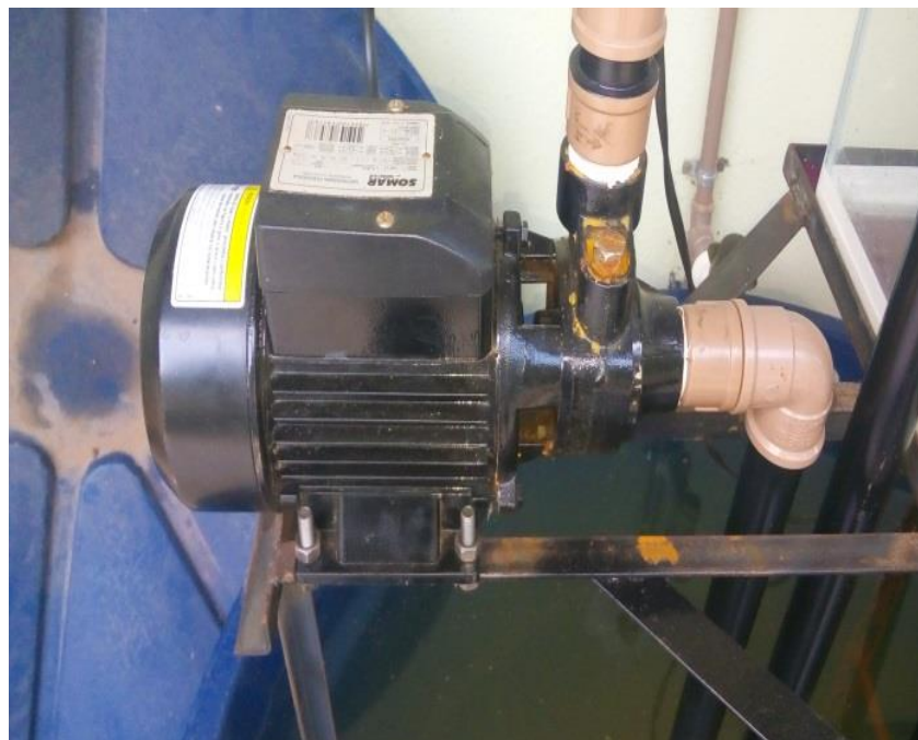
Figura 12: Conjunto motor/bomba 0,5cv (SOMAR)
