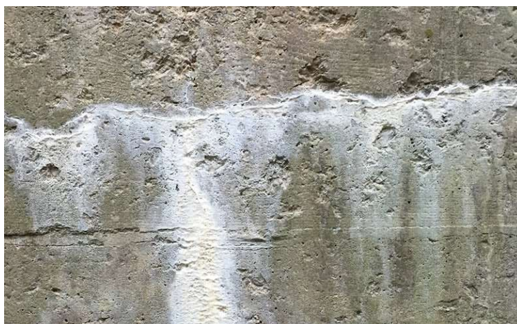
Figura 4- Lixiviação no concreto
