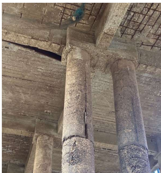
Figura 12 – Rachadura em pilar
