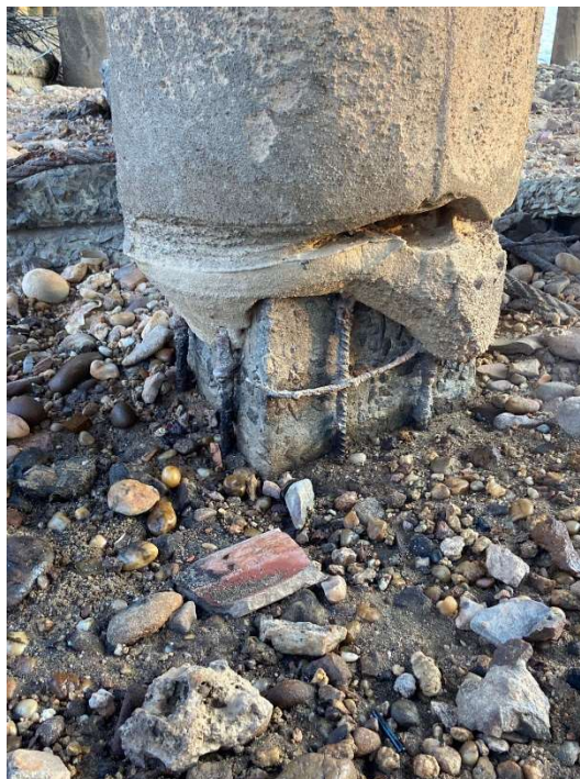
Figura 16 – desagregação do reforço estrutural
