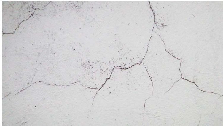
Figura 3 – Fissuras no concreto
