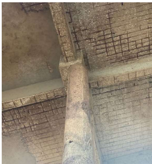
Figura 11- Excentricidade do pilar com a viga
