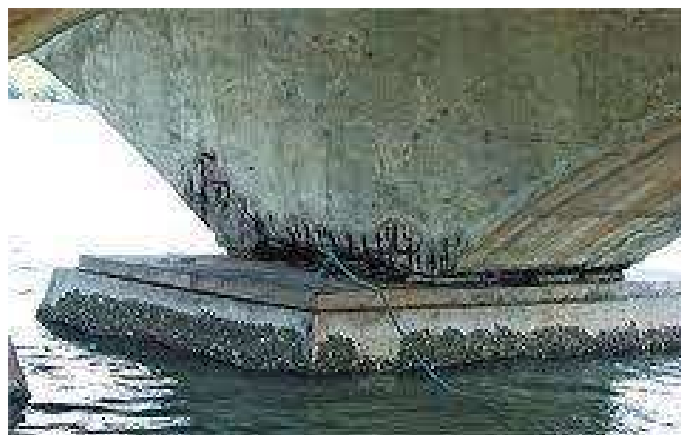
Figura 7 – Estrutura de ponte que sofreu processo de corrosão do concreto
