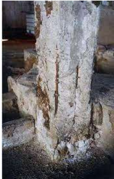
Figura 6- Pilar degradado pela ação íons sulfato
