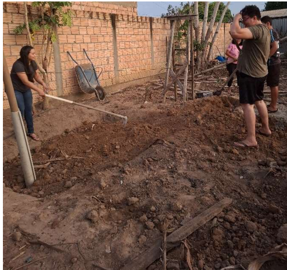
Figura 12 – Recobrimento da BET com terra da vala escavada e adubo para plantio.
