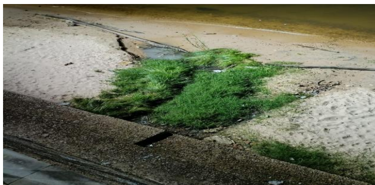
Figura 8: Águas residuais diretamente ao rio
