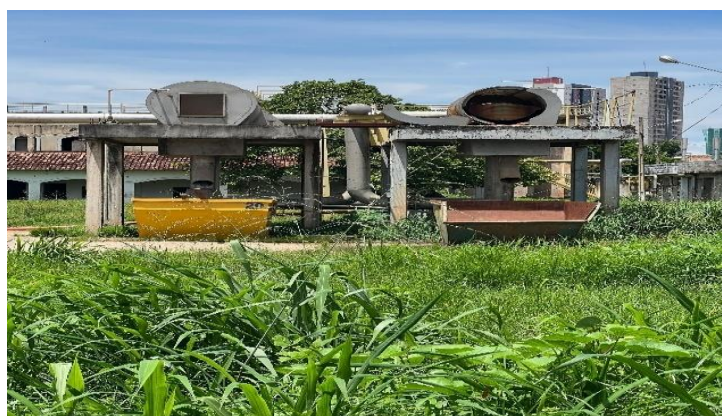
Figura 17: Centrífuga de saída de esgoto frente
