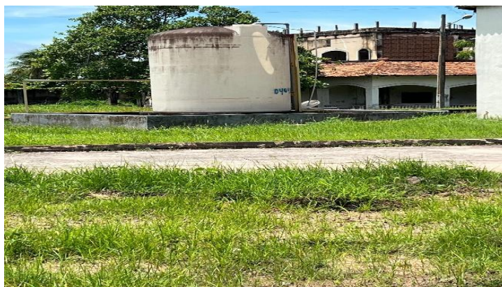
Figura 15: Dosador de cloro
