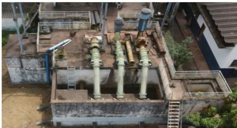
Figura 6: Imagem de uma bomba-motor que realiza o tratamento das águas
