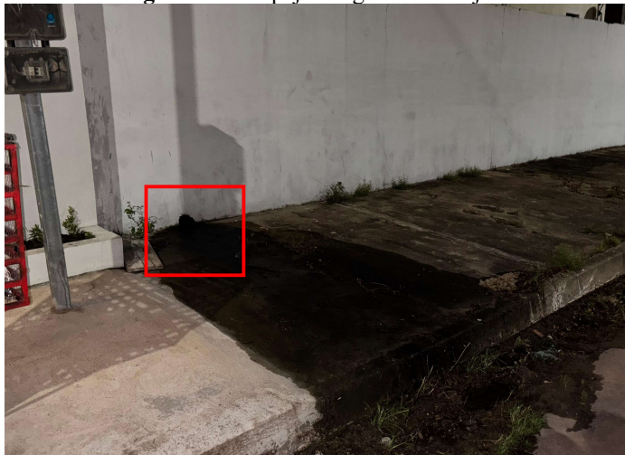
Figura 1 – Despejo irregular nas sarjetas
