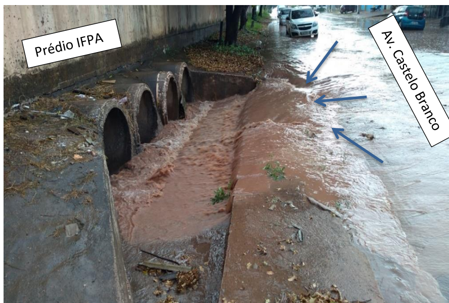
Figura 12 - Infraestrutura feita para o escoamento superficial.
