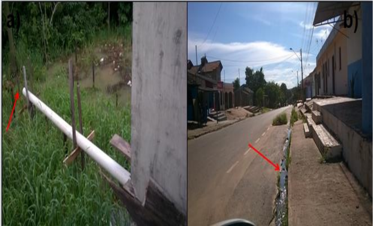
Figura 23: a) Lançamento de dejetos humanos diretamente em um corpo de água; b) Despejo de efluente nas vias públicas.
