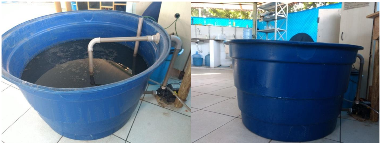
Figura 5- Reservatório de armazenamento do esgoto coletado.
