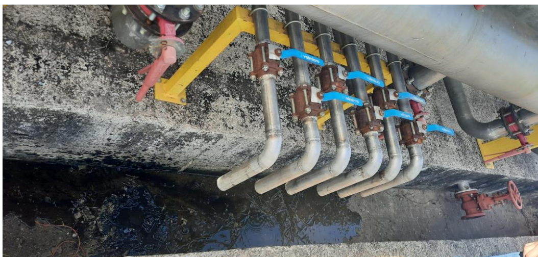
Figura 33: Tubulações externas ao U-Box
