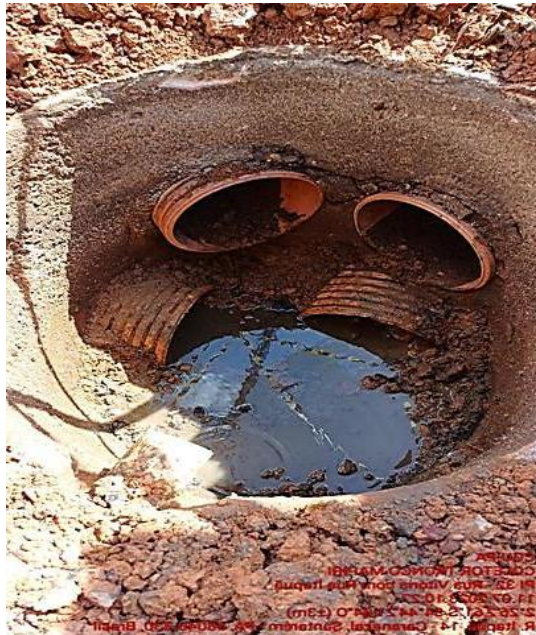
Figura 9: Drenagem com coletor tronco. Ligação irregular
