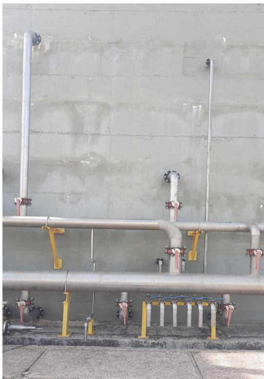
Figura 34: Tubulações externas ao U-Box
