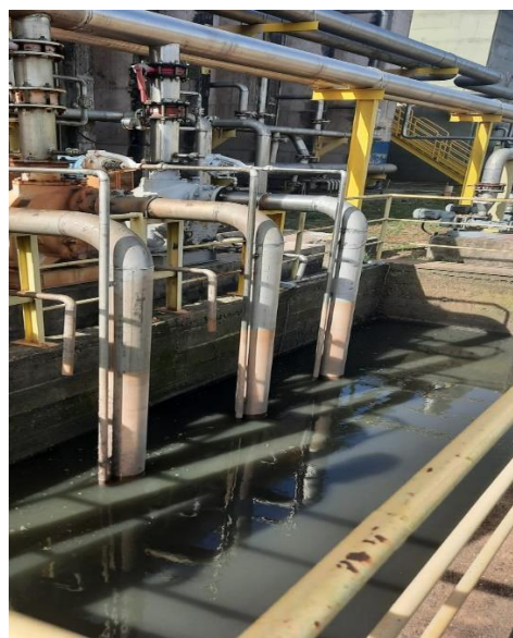
Figura 27: Poço e Bombas re-autoescorvantes
