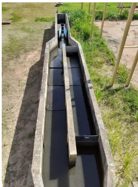
Figura 26: Calha de Parshall
