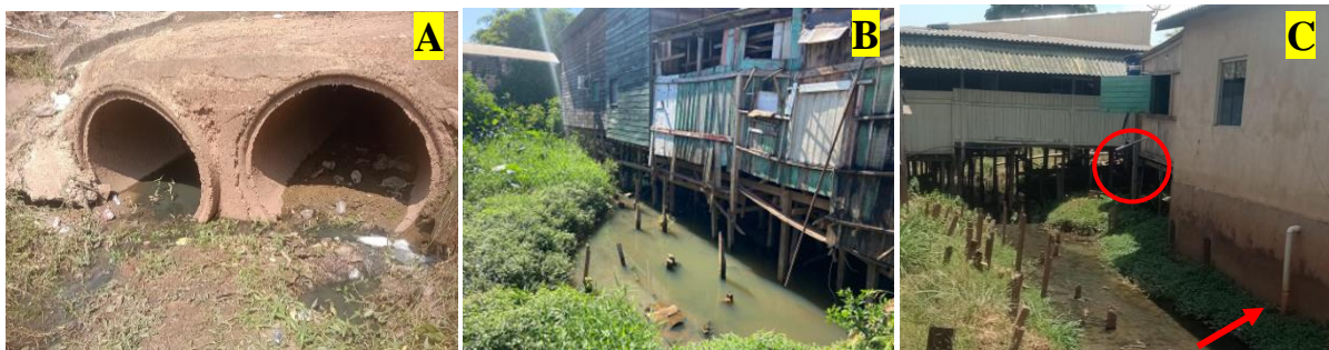
Figura 15 – Registros fotográficos no ponto de interesse na Tv. 15 de Agosto, com ênfase: A) tubulações auxiliares obstruídas e inutilizadas; B) habitações e entulhos no leito do córrego, C) lançamento de efluentes domésticos direto no canal.
