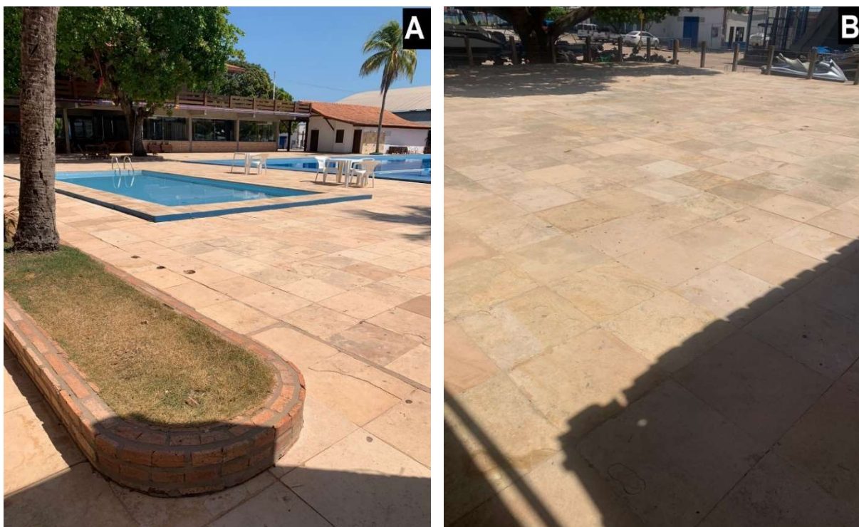
Figura 6 - Pedra Cariri usada como revestimento. (A) Em volta da piscina. (B) Em área de circulação.
