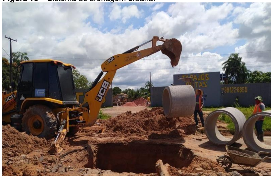
Figura 18 – Sistema de drenagem urbana.
