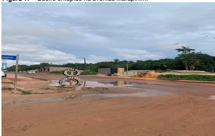
Figura 17 – Bueiro entupido na avenida Marapinim.
