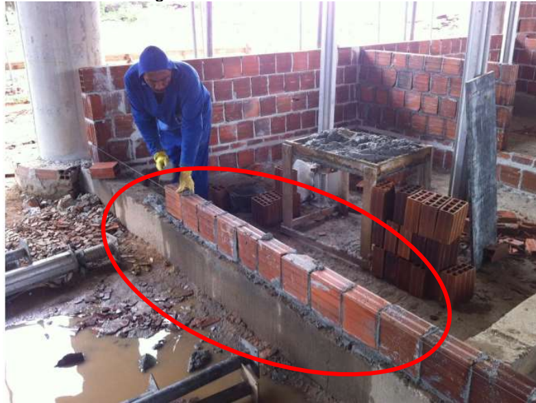
Figura 7 - Umidade em alvenaria
