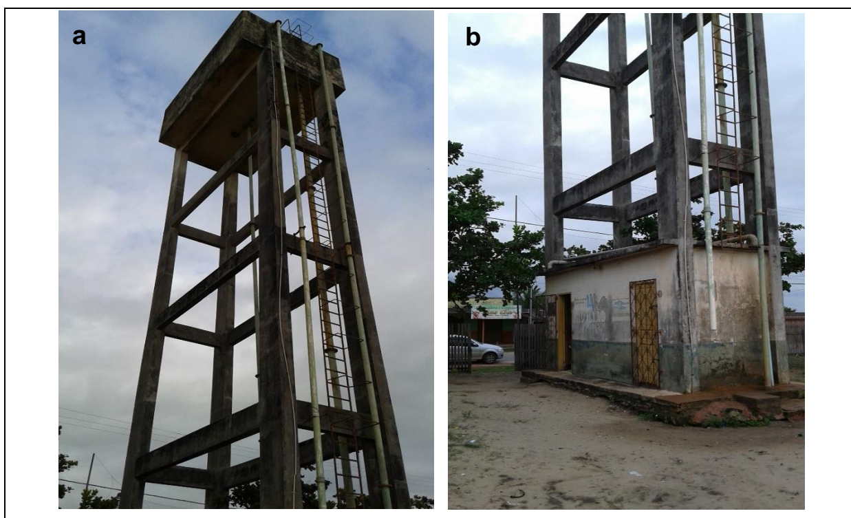
Figura 5 – a) Reservatório Elevado e b) Casa de Força Fonte: Os autores, 2017.
