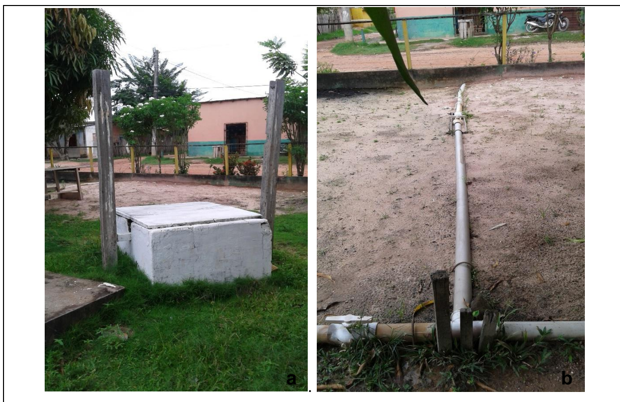
Figura 6 – a) Poço Subterrâneo e b) Sistema de Distribuição Fonte: Os autores, 2017.
