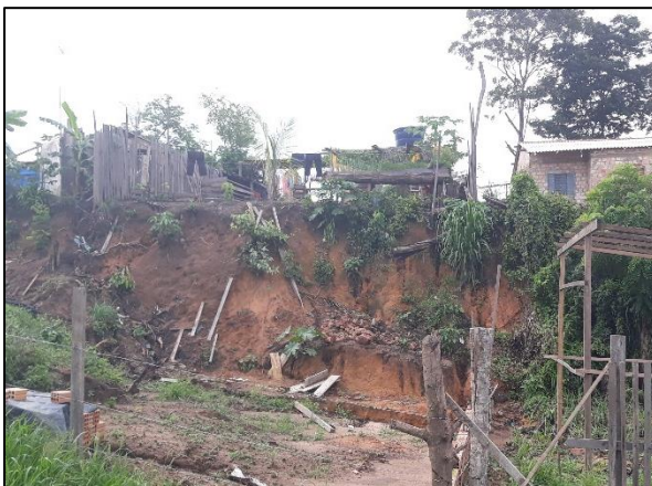
Figura 11: Erosão na área.
