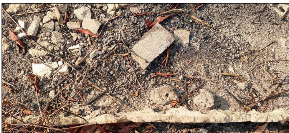
Figura 41- Ruínas da parede da igreja católica.
