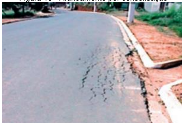
Figura 13 - Afundamento por consolidação
