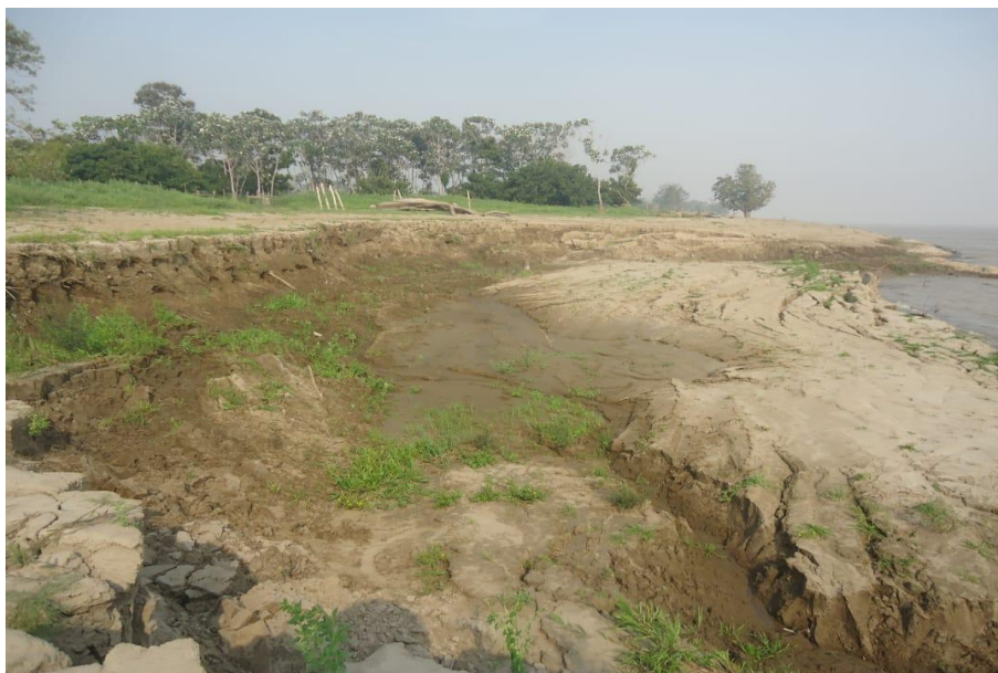
Figura 8: Área de terras caídas na Vila Vieira
