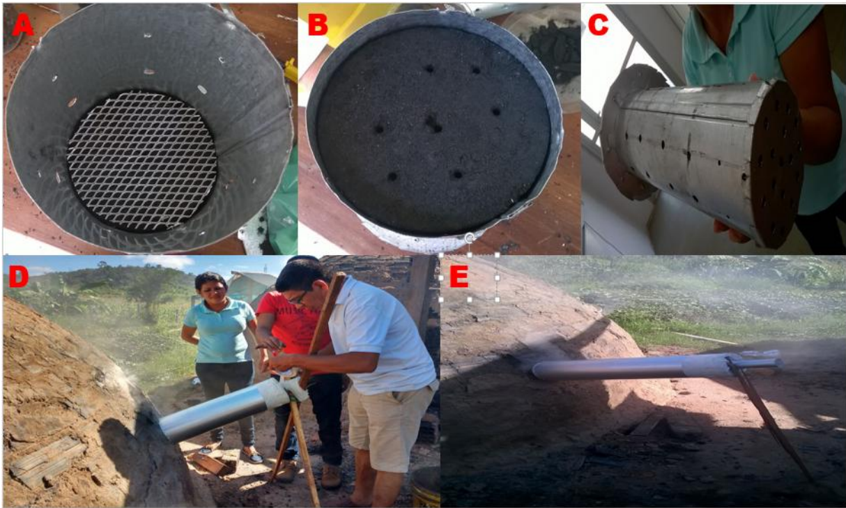
Figura 15: A- B- Etapas da montagem do filtro; C- Filtro Montado; D- Instalação do Filtro na Carvoaria; E- Filtro instalado. Fonte: Este estudo.
