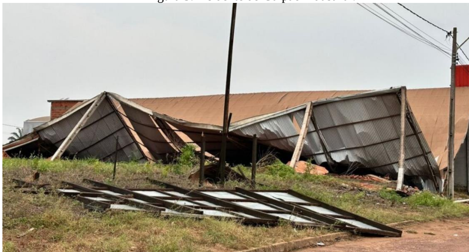
Figura 5: Acidente do Galpão industrial.
