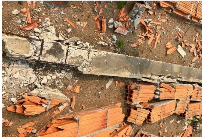
Figura 17: Corrosão de cobrimento.
