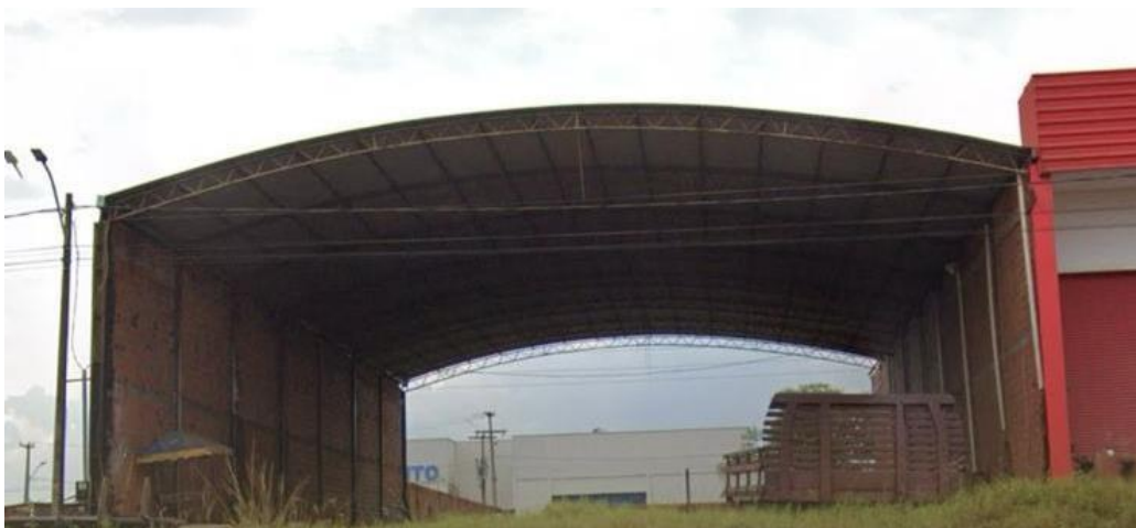
Figura 18: Ausência de contraventamento.
