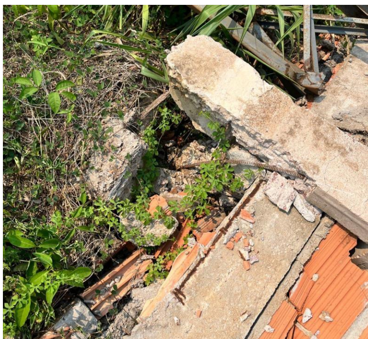
Figura 16: Inexistência de fundação.
