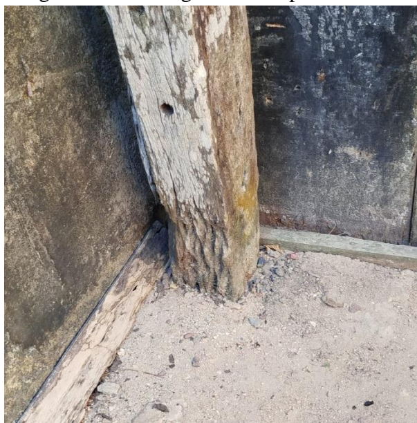
Figura 16 - Patologia causada por umidade.
