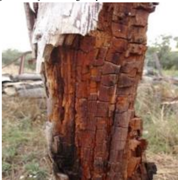
Figura 7 - Ação de fungos apodrecedores na madeira.
