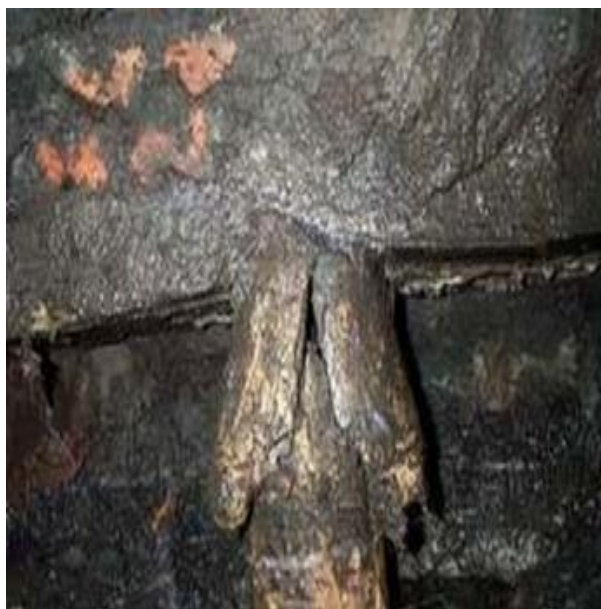
Figura 4 - Biodeterioração de estacas de madeira por bactérias.
