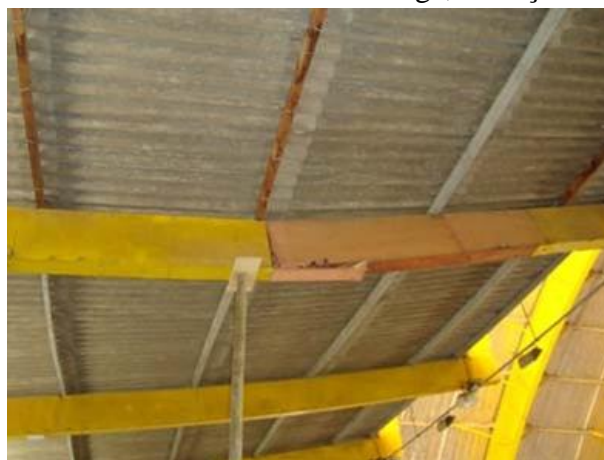
Figura 2 - Ruptura localizado no meio do vão da viga, de seção composta de madeira.
