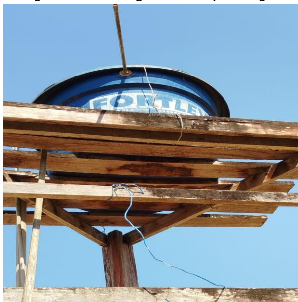
Figura 17 - Patologia causada por fungos.
