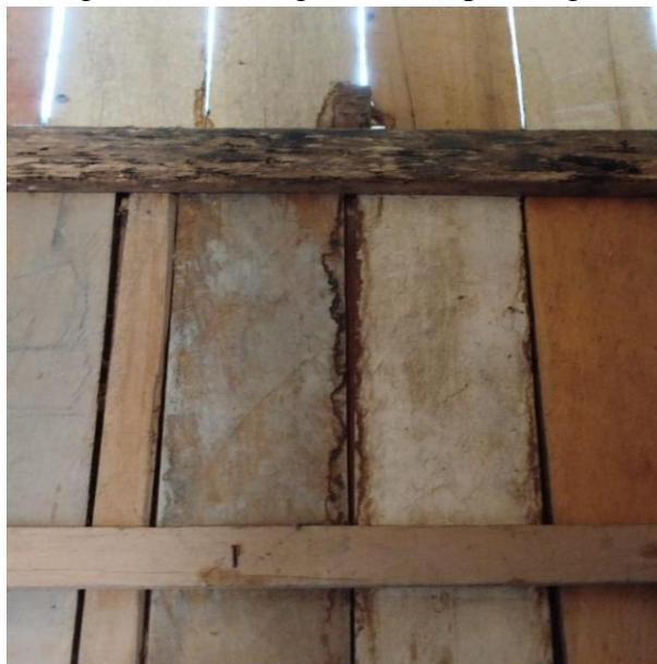
Figura 18- Patologia causada por fungos.
