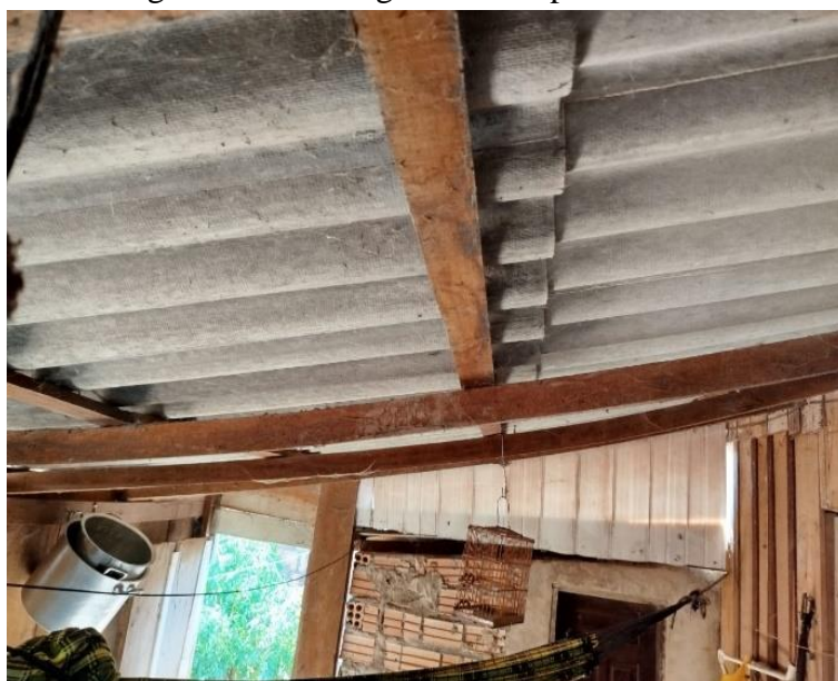
Figura 14 - Patologia causada por umidade.
