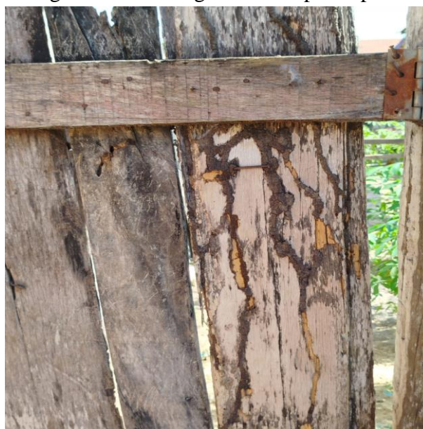
Figura 19 - Patologia causada por cupins.
