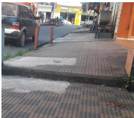
Figura 20: Calçada desnivelada, deteriorada e ocupada, Centro de Santarém.
