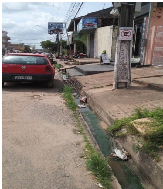
Figura 3: Calçadas desniveladas e ocupadas.
