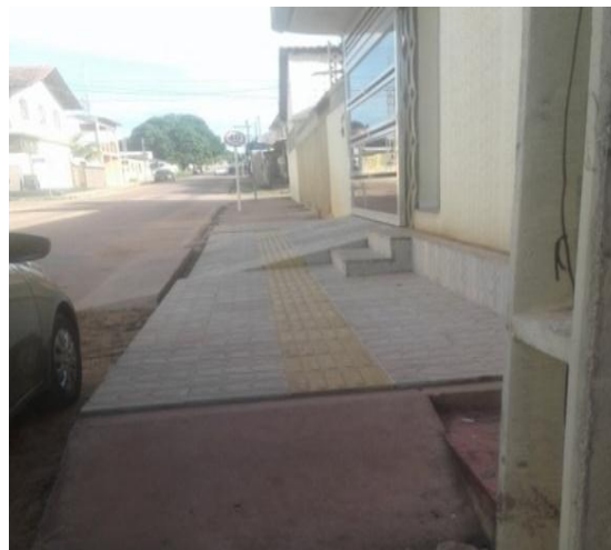
Figura 18: Irregularidade na construção de calçadas normatizadas.
