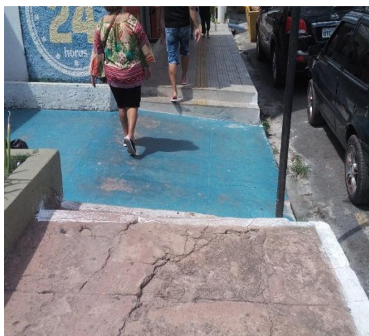
Figura 19: Deterioração de calçadas, Centro de Santarém.
