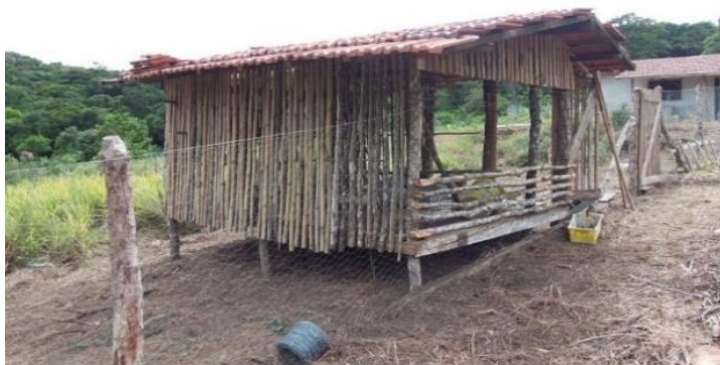
Figura 6 - Paredes laterais do aviário feitas de bambu, substituindo tabuas.
