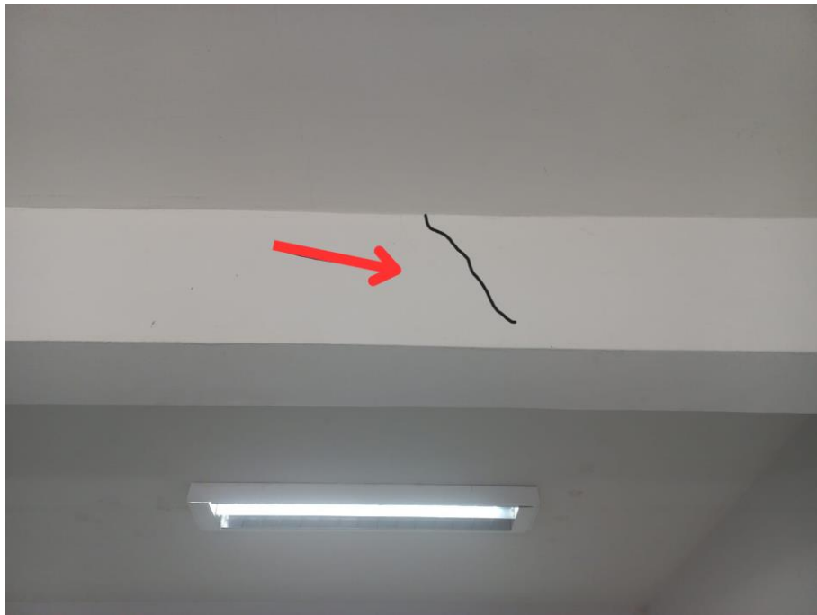
Figura 20 - Fissura na V51 vão 1 do auditório.
