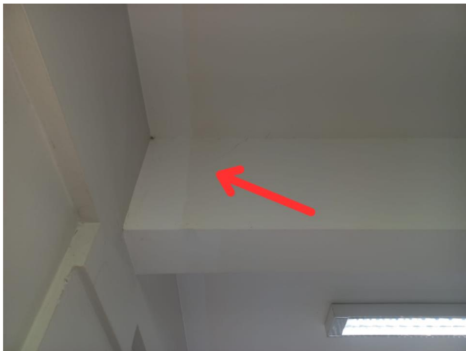
Figura 36 - Fissura inclinada próximo ao apoio na V52 vão 4 do auditório.
