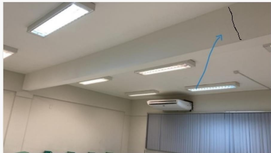
Figura 26 - Fissura na V52 vão 1.
