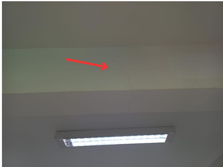
Figura 40 - Fissuras na V55 vão 4.
