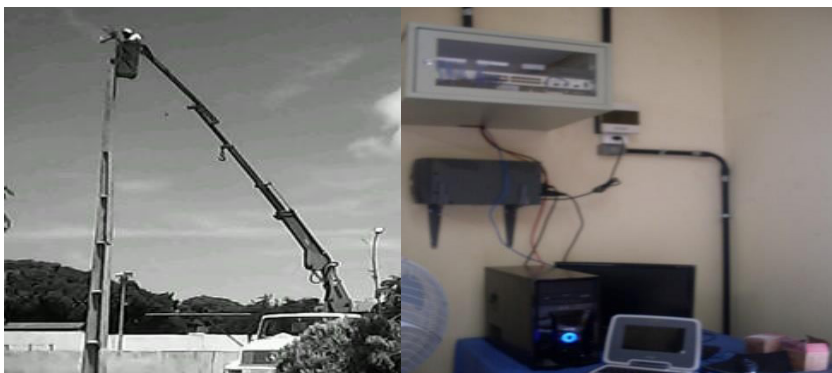
Figura 4 – Instalação da antena e do servidor de internet
