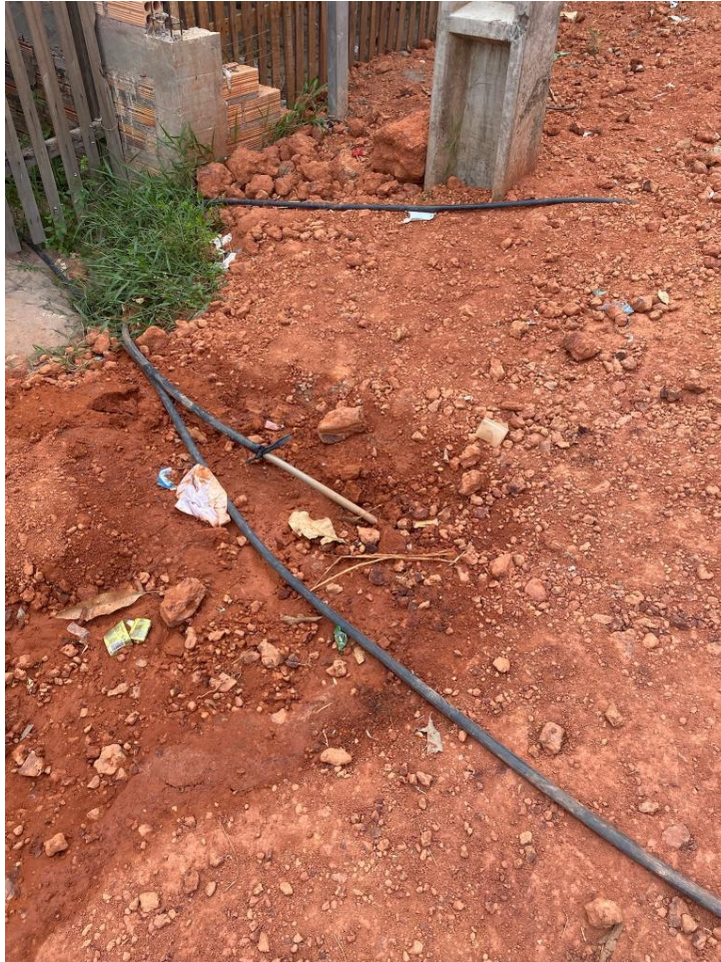
Imagem 9 - Rede de abastecimento de água por mangueiras cruzando as vias públicas.
