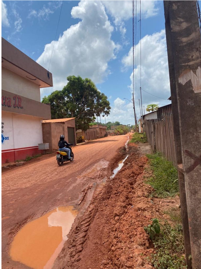
Imagem 10 - Sistema Viário e valas de esgoto a céu aberto
