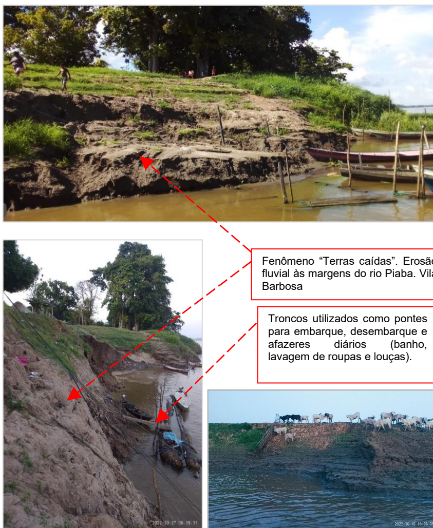
Fotos 1 a 3. EROSÃO FLUVIAL ÀS MARGENS DO RIO PIABA – VILA BARBOSA
