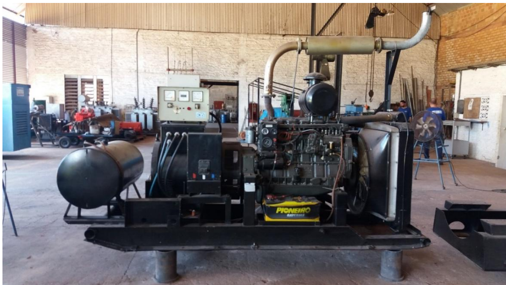
figura 1 - Grupo Moto-Gerador (GMG)
