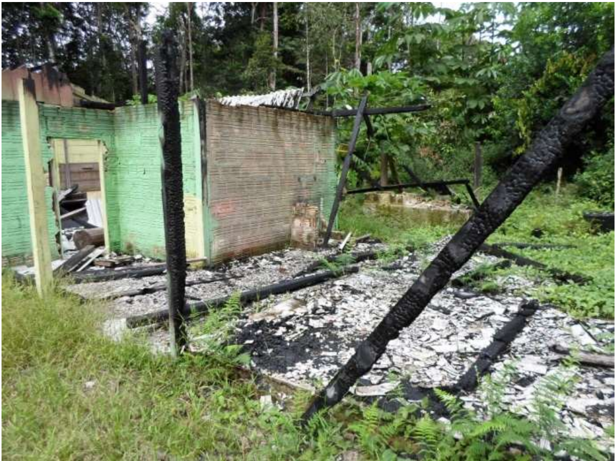
Figura 3 – Edificações onde ficavam a cozinha e refeitório queimados
