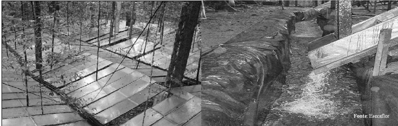
Figura 14 - Painéis coletores de água, calhas de drenagem e trincheira.
