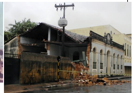
Desmoronamento de parte da fachada, ano 2011. Fonte: Antônio Júnior Farias, 2011.
