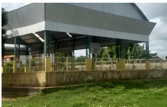
Figura 5. Obra da cobertura da quadra poliesportiva da Escola de Tempo Integral Frei Fabiano Merz
