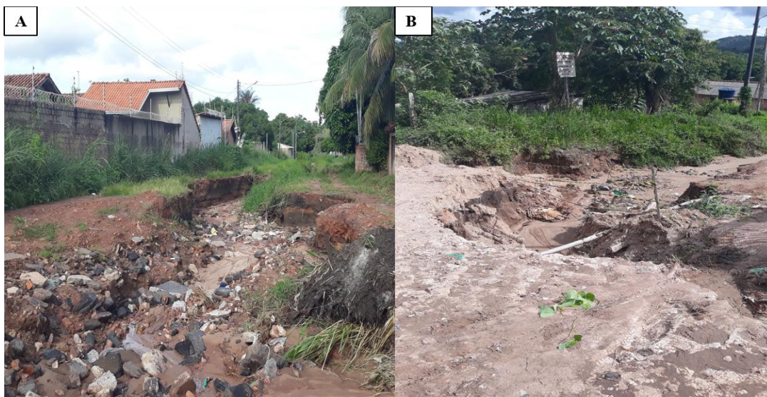
Figura 8 – Pontos de erosão acentuada (ravinas) nos bairros (A) Maracanã I e (B) Maicá na cidade de Santarém, Pará, Brasil.
