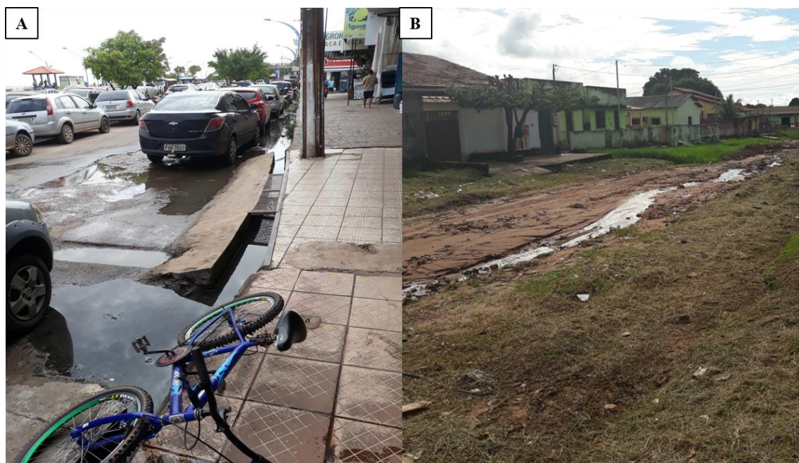
Figura 5 – Esgoto a céu aberto nos bairros (A) Centro e (B) Maracanã I na cidade de Santarém, Pará, Brasil.
