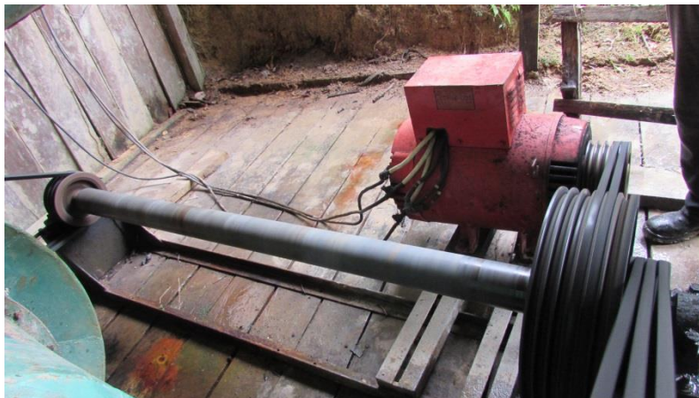
Figura 31 - Gerador acoplado ao eixo das duas turbinas
