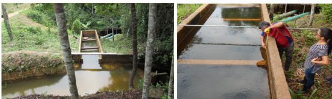
Figura 27 - Sistema de adução. (a) vista desde o canal de adução até o conduto forçado. (b) câmara de carga com vistas para o conduto forçado
