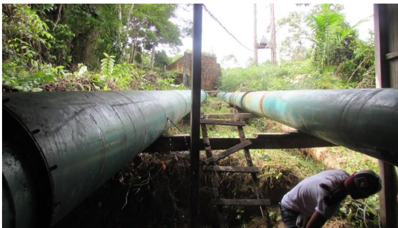
Figura 28 - Conduto forçado por tubulação até as turbina
