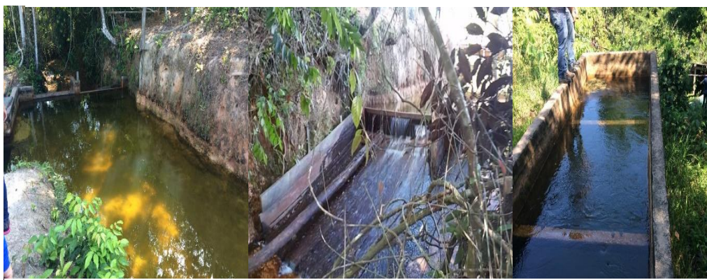
Figura 35 - (a) Parte do reservatório. (b) Vertedouro. (c) canal de adução-câmara de carga
