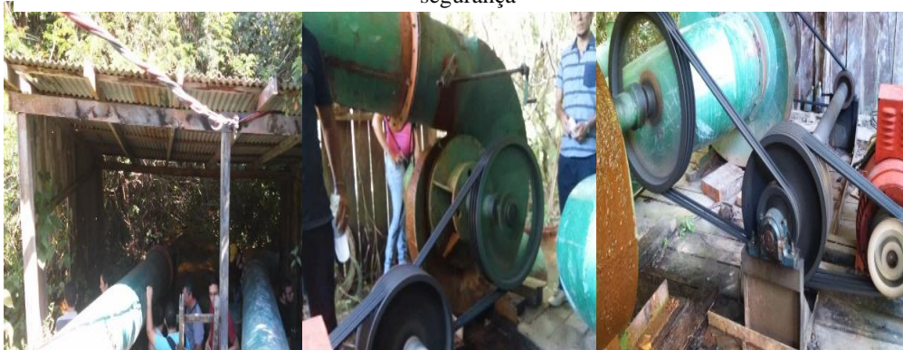
Figura 36 - (a) acesso à casa de máquinas. (b) Turbinas. (c) equipamentos sem proteção de segurança
