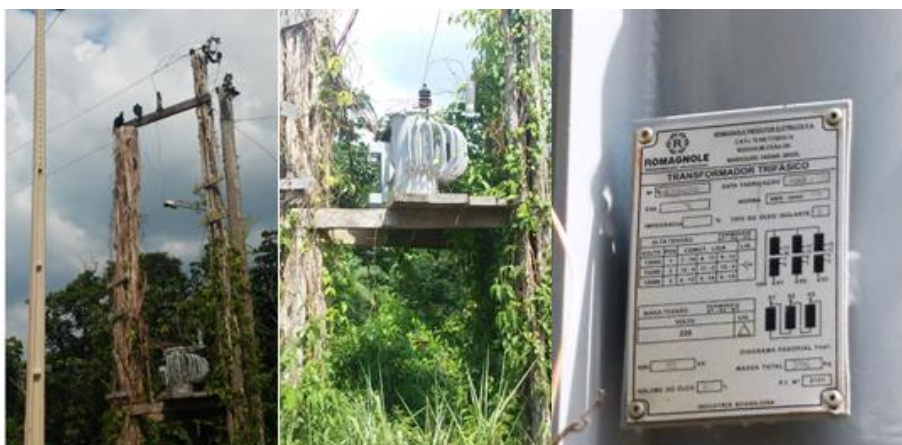
Figura 34 - Transformador e suas instalações
