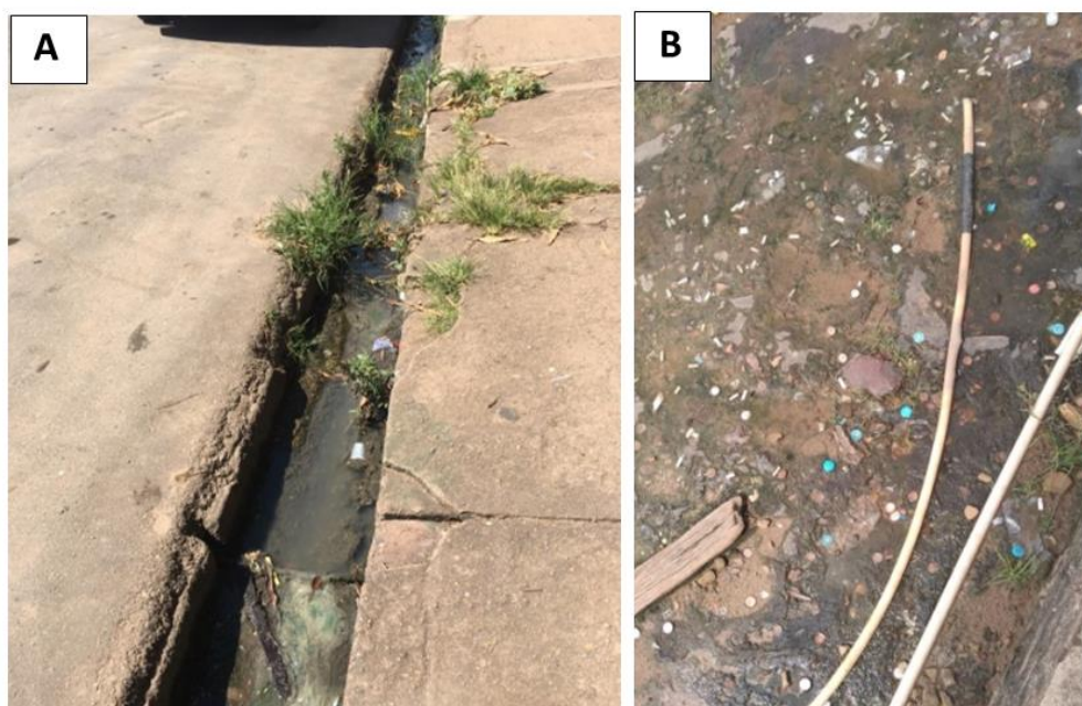
Figura 8– Efluentes escoando a céu aberto na área Portuária: Trecho Mercado 2000-Matriz (A) e Porto DER (B).
