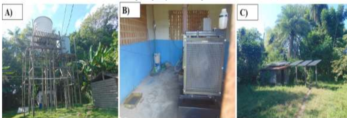
Figura 9. Infraestrutura de caixa d'água utilizada como reservatório (A). Local do gerador de energia (B). Placas solares utilizadas para geração de energia do microsistema (C).
