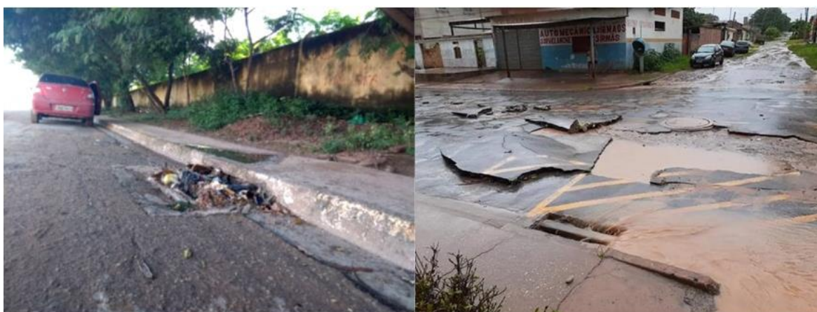
Figura 9 - Boca de lobo obstruída por lixo na Avenida Mal. Castelo Branco, bairro Interventoria (r); Avenida Castelo Branco no bairro Interventoria (s).
