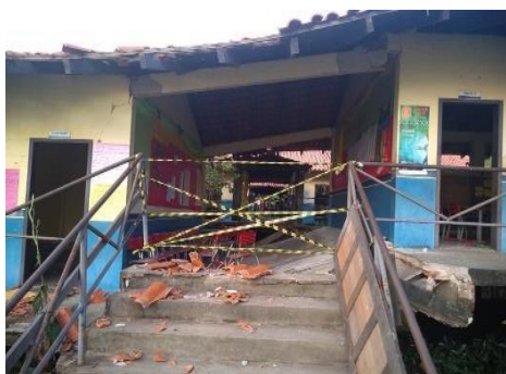
Imagem 21 - Escola Interditada pela Defesa Civil.
