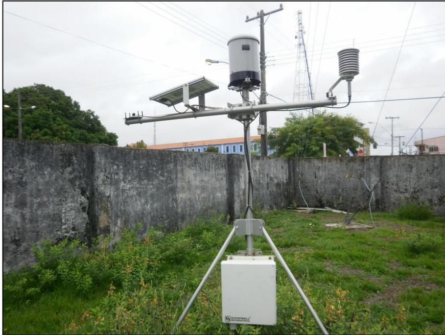
FIGURA 03 - Estação meteorológica automática da Campbell Scientific. Localizada no Ponto 01 - Centro. Fonte: Paulo Uchôa.
