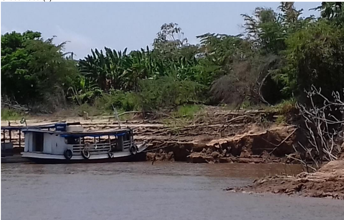
Fotografia 36 - Área atingida pelo fenômeno das terras caídas na Comunidade São Ciriaco do Urucurituba (2)
