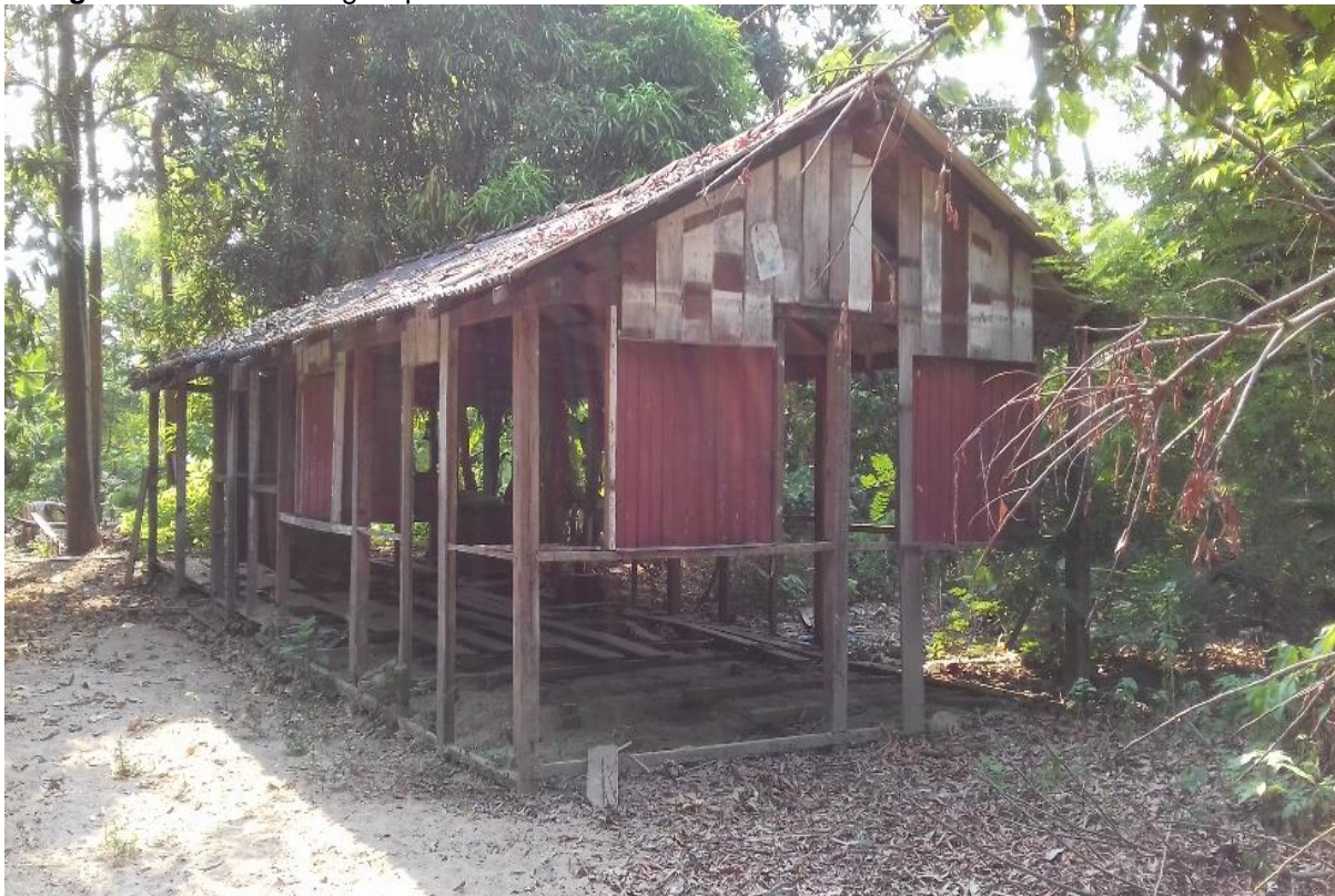
Fotografia 27 - Casa atingida pelas terras crescidas na Comunidade São Ciríaco do Urucurituba
