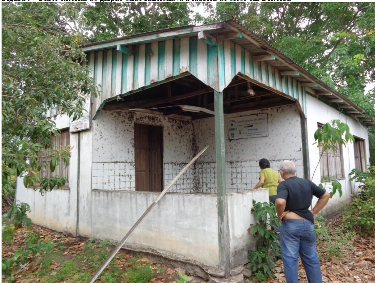
Figura 9 - Parte externa do galpão onde funcionava a fábrica de óleos em Belterra
