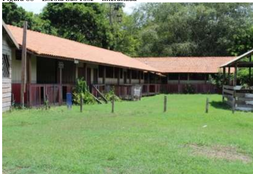
Figura 66 – Escola São José – interditada
